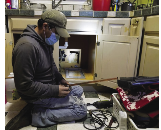
(ARRIBA) El contratista Roberto Valerio trabaja en la reparación de una tubería rota en la casa de Nora Espinoza en Dallas. La tubería se rompió durante las temperaturas congelantes provocadas por el clima invernal.
